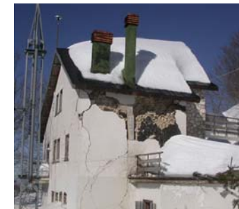
Villetta distrutta da una fuga di gas
